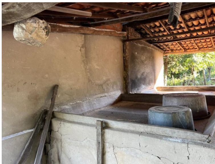
FIGURA 5: CASA DE FARINHA DA COMUNIDADE DE PAMBU/ARAÇÁ
