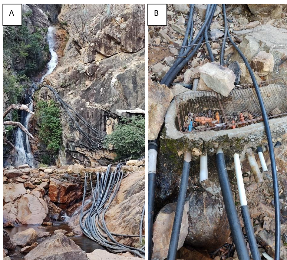
Figura 30 – Sistema de captação de água no entorno do PECG.
