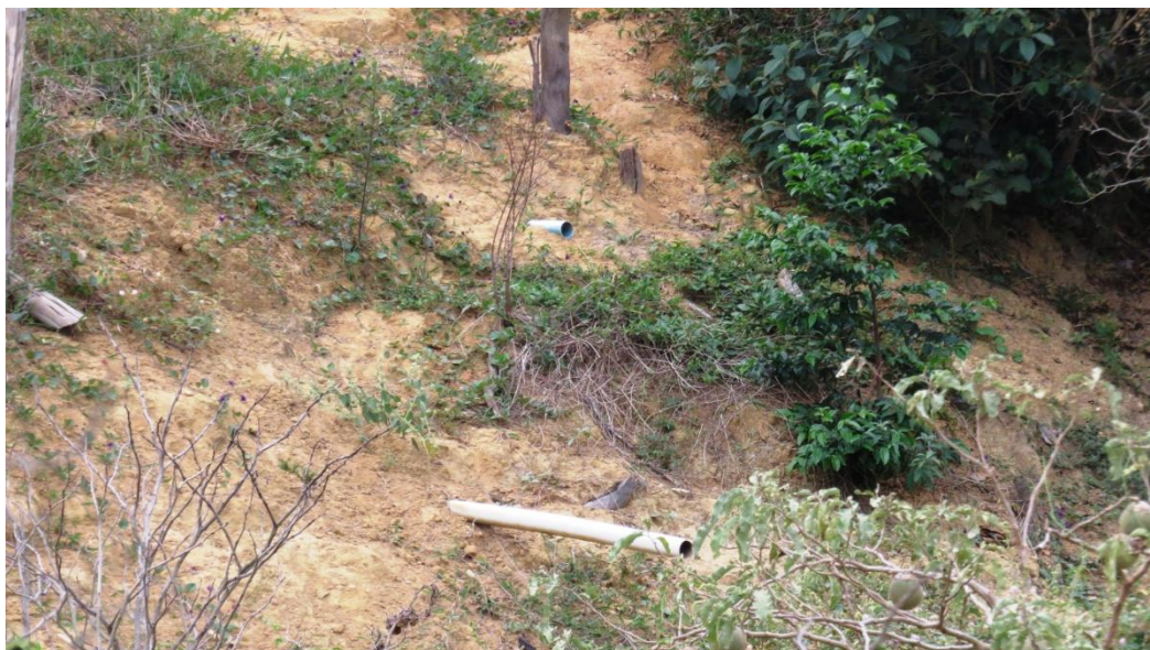
FIGURA 53 - Encanamentos no barramento que distribuía água para a comunidade de Catanduvas. Fonte: DAYRELL, 2018.
