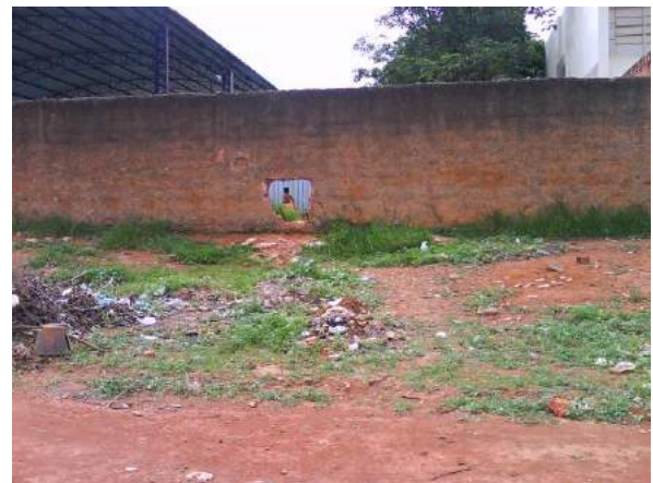
FIGURA 6 - Passagem improvisada na parede lateral da Escola Estadual Antônio Canela que dá acesso à quadra
