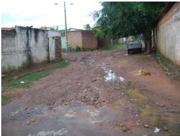
FIGURA 14 - Rua 10, sem pavimentação. AUTORA: CASTRO, G. F.; 21/01/2009
