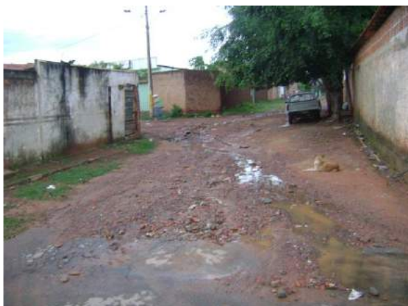
FIGURA 16 - Parte da Rua 10, sem pavimentação AUTORA: CASTRO, G. F.; 19/01/2009
